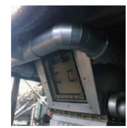
集塵機マンホール
